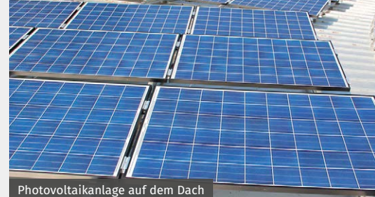
Photovoltaikanlage auf dem Dach
