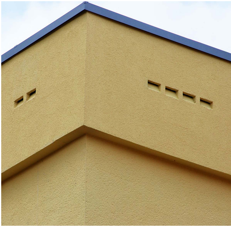
▲ Niststeine für Fledermäuse – dezent in die Fassade integriert und hinterdämmt
