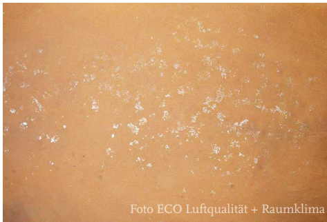
Schimmel auf brauner Lehmwand ▶
