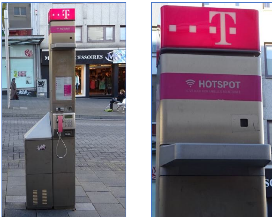
Abb. 6: Mikrozelle der Telekom mit LTE- oder 5G-Mobilfunk (Hotspot) in einer Fußgängerzone
