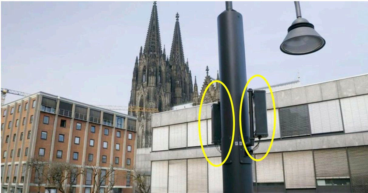
Abb. 13: Köln wird zur Smart City: Small-Cells an Straßenlaternen versorgen die Stadt mit 5G Echtzeit-Mobilfunk. - Foto: Vodafone [11]
