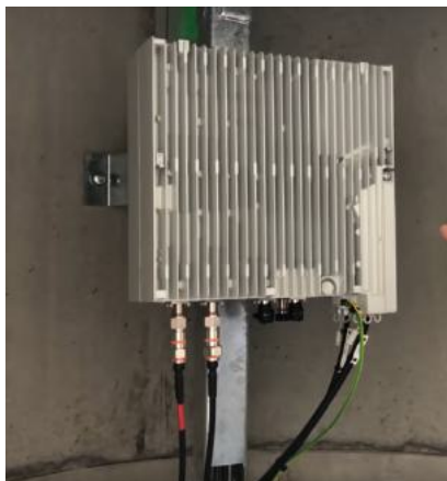
Abb. 3: LTE-Systemtechnik im Inneren der Litfaßsäule; die Hochfrequenzleitungen führen zur Antenne im Dach [3]
