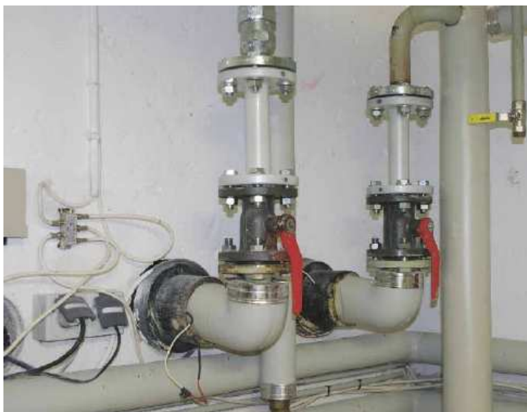
Abb. 2: Fernwärmerohre mit Isolierflanschen oberhalb der Kugelhähne
